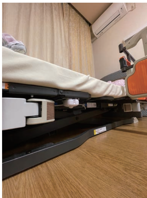
ベッド下に設置されたセンサー
