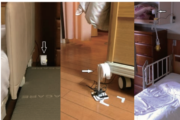
機器の設置状況
